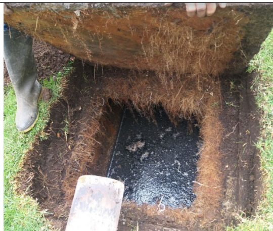
Foto 6. Caja de inspección 2.
