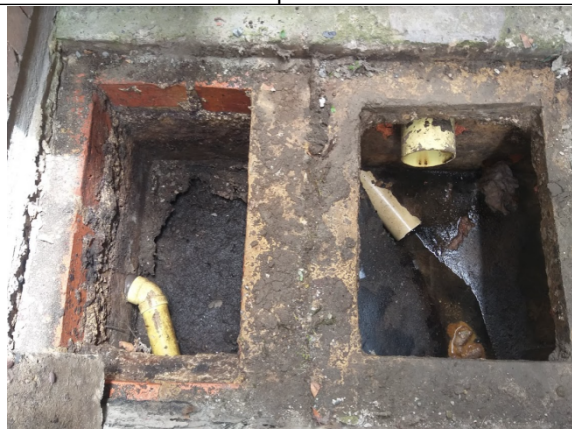
Foto 4. Caja de inspección 1.
